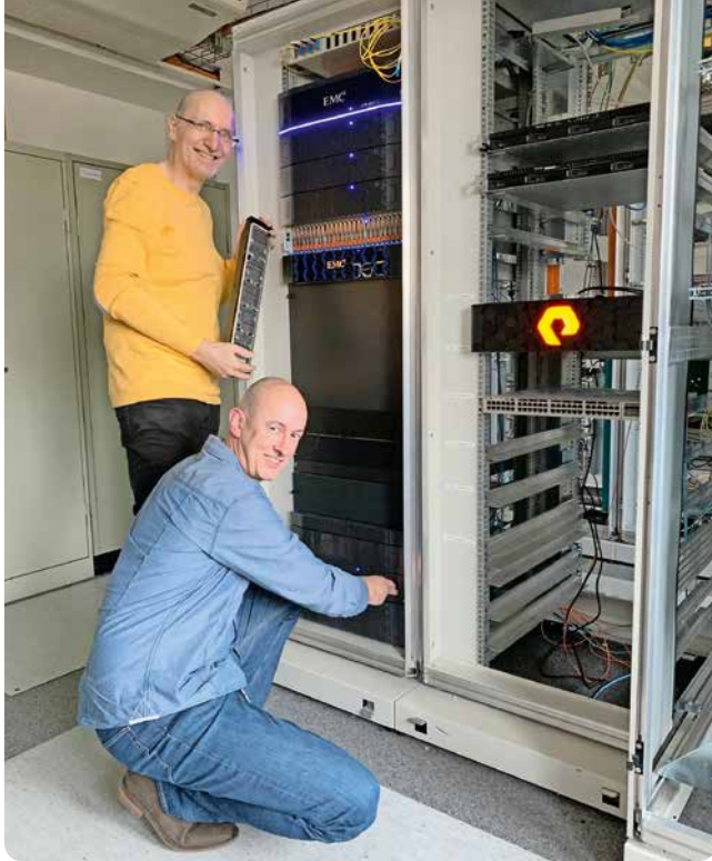
Klaus Sander und Silvester Jordan aus der IDS vor den TiHo-Speichern. Im linken Turm sind die Speichersysteme des alten System mit Festplatten zu sehen, rechts, sehr viel kleiner, der Flash-Speicher
